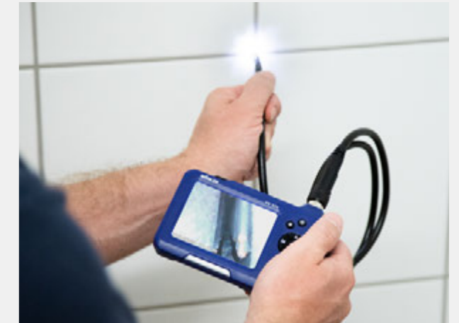
Bereits eine Ø 4 mm Öffnung in einem Fliesenkreuz reicht aus, um die Installation hinter der Wand zu begutachten (im Bild Wöhler VE 320).
