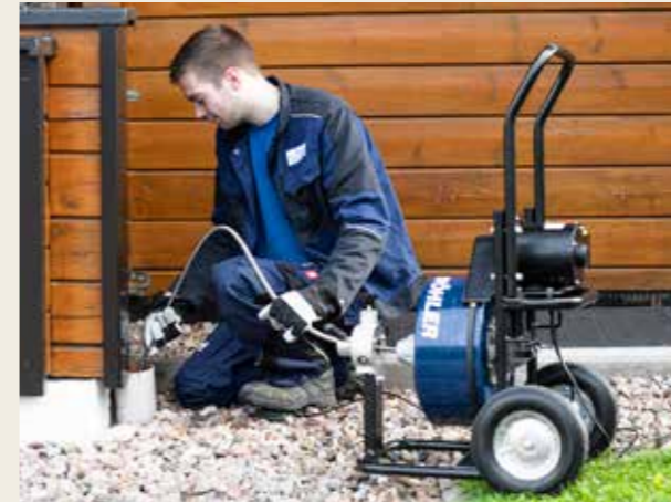
Auch im Außenbereich können Abflüsse mit der Wöhler RM 400 Rohrreinigungsmaschine gereinigt werden.
