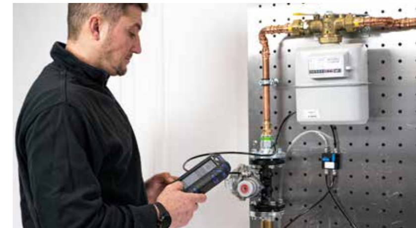
Ein eigener Menüpunkt sorgt dafür, dass die Funktionsfähigkeit des Gasreglers inkl. SAV-Prüfung in wenigen Minuten getestet werden kann.
