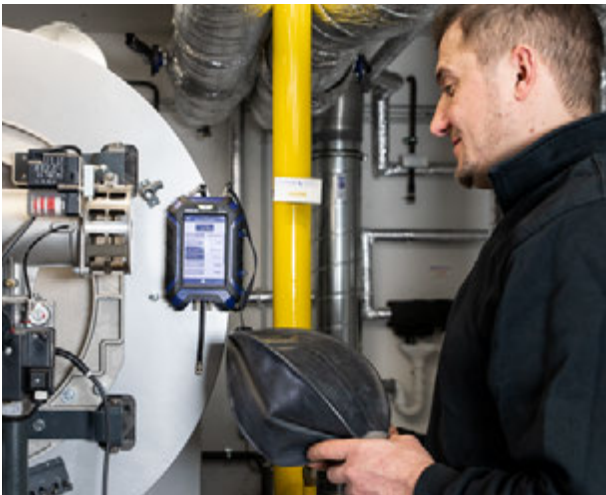
Die Gebrauchsfähigkeitsprüfung lässt sich sicher mit Betriebsgas bei Betriebsdruck durchführen, so dass die Leitung nicht gespült werden muss.
