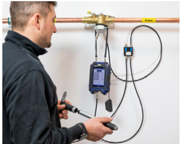
Mit dem passenden Anschluss-Zubehör wird die neu installierte Gasleitung ganz einfach mit dem Prüfdruck für die Belastungsprüfung (1 bar) beaufschlagt.
