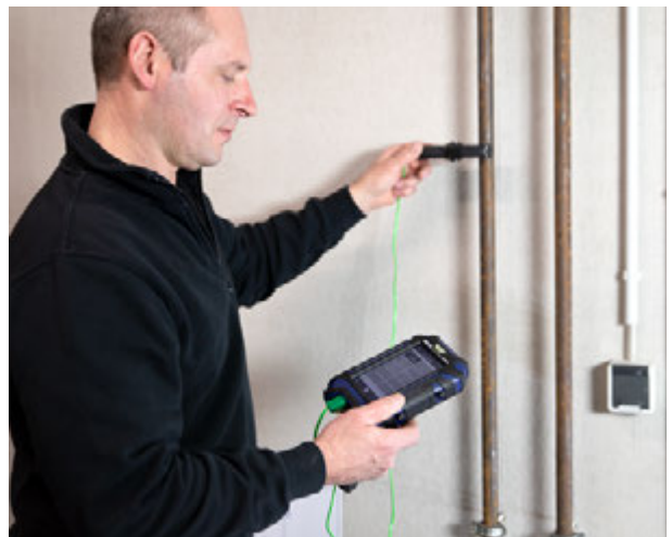
Mit der Temperaturmesszange lässt sich die Rohrtemperatur bestimmen.
