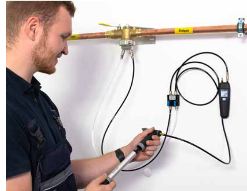
Mit dem passenden Anschluss-Zubehör wird die neu installierte Gasleitung ganz einfach mit dem Prüfdruck beaufschlagt.
