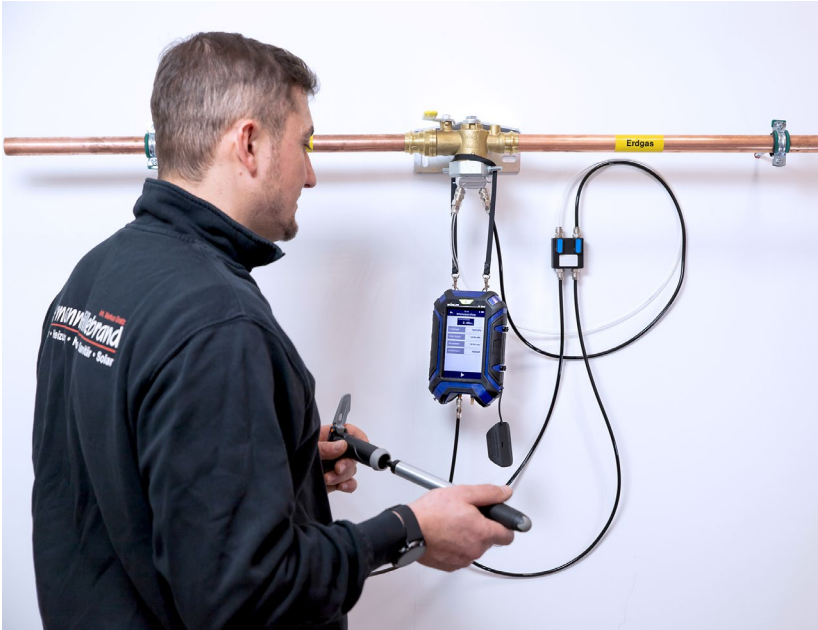
Abb. 9: Anschlüsse mit Einrohrzählerkappe und Wöhler M 603
