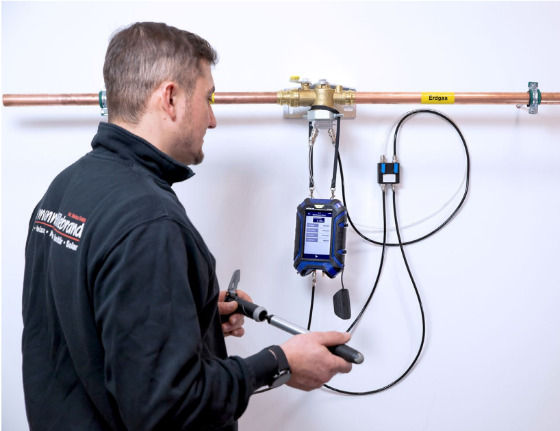
Abb. 9: Anschlüsse mit Einrohrzählerkappe und Wöhler M 603
