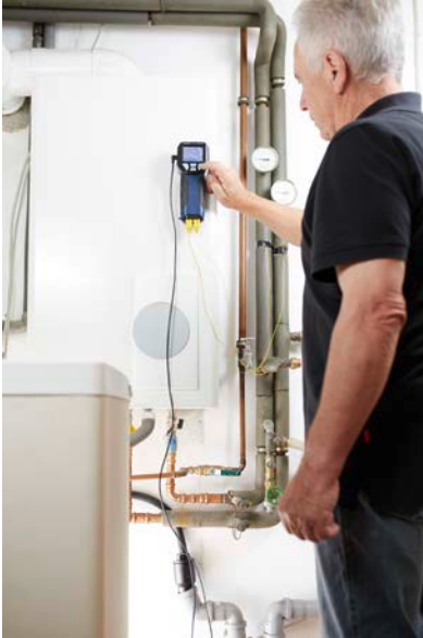
Abb. 15: Durchführung des Brennwert-Checks mit dem Wöhler DC 440
