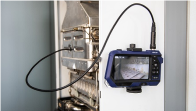
Abb. 5: Endoskop an Wand befestigt
