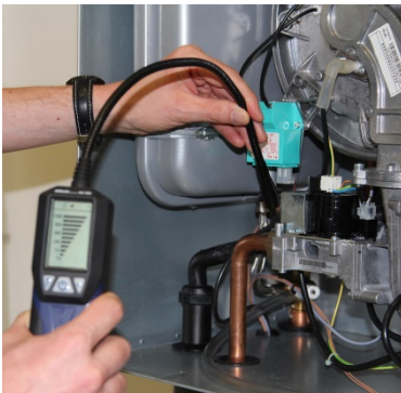
Abb. 5: Der Gasspürer zeigt ein deutliches Signal, wenn er an den leicht geöffneten Messstutzen gehalten wird.
